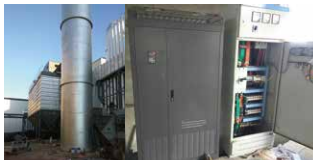
CV3100-630KW变频器在除尘器设备上的应用
