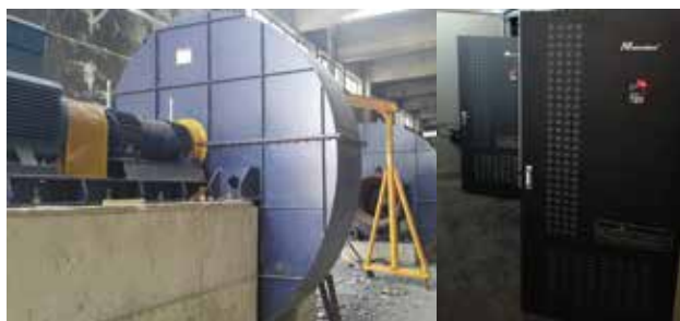
在供暖锅炉离心风机上的应用
