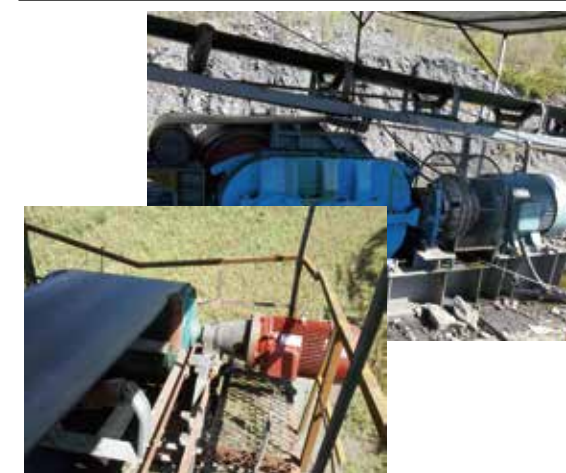
易驱变频器六盘水某矿的现场
